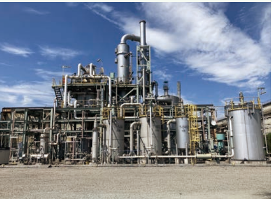
対策例：オファガス処理設備（姫路製造所）
