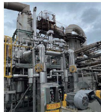
九州製造所 硫安ベントガス対策
