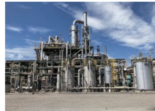
対策例: オフロガス処理設備(広畑製造所)
