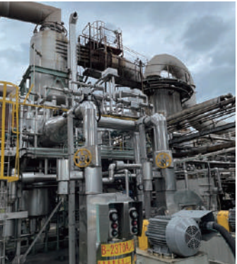
九州製造所 硫安ベントガス対策
